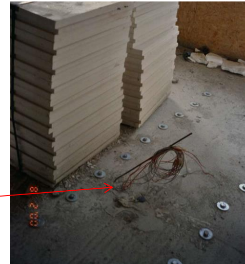
Kabel der DMS an der Oberseite
