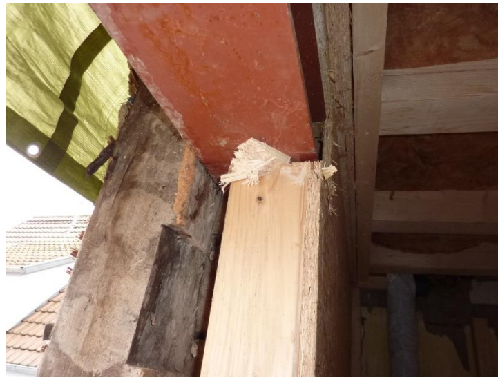
Auflagerung Stahlträger sach- und fachgerecht?
